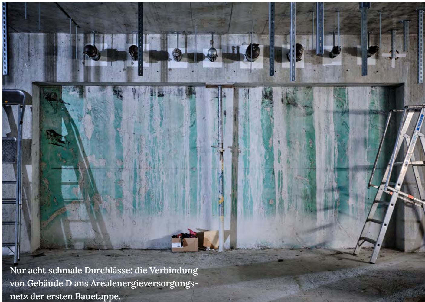
Detailaufnahme der Heizungsrohre im 1. UG.
